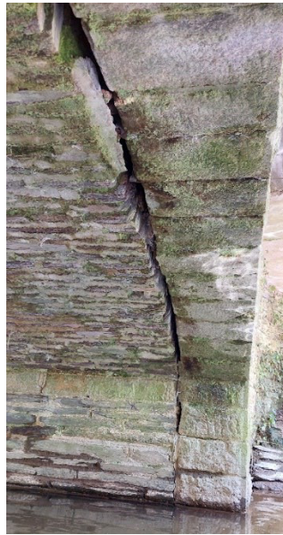
Figure 7 Décollement du bandeau au niveau de la voûte (ouverture 6cm)
