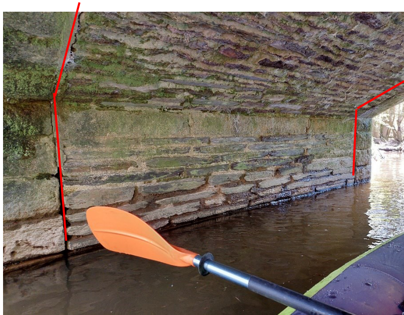
Figure 8 Décollement du bandeau au niveau des piédroits
